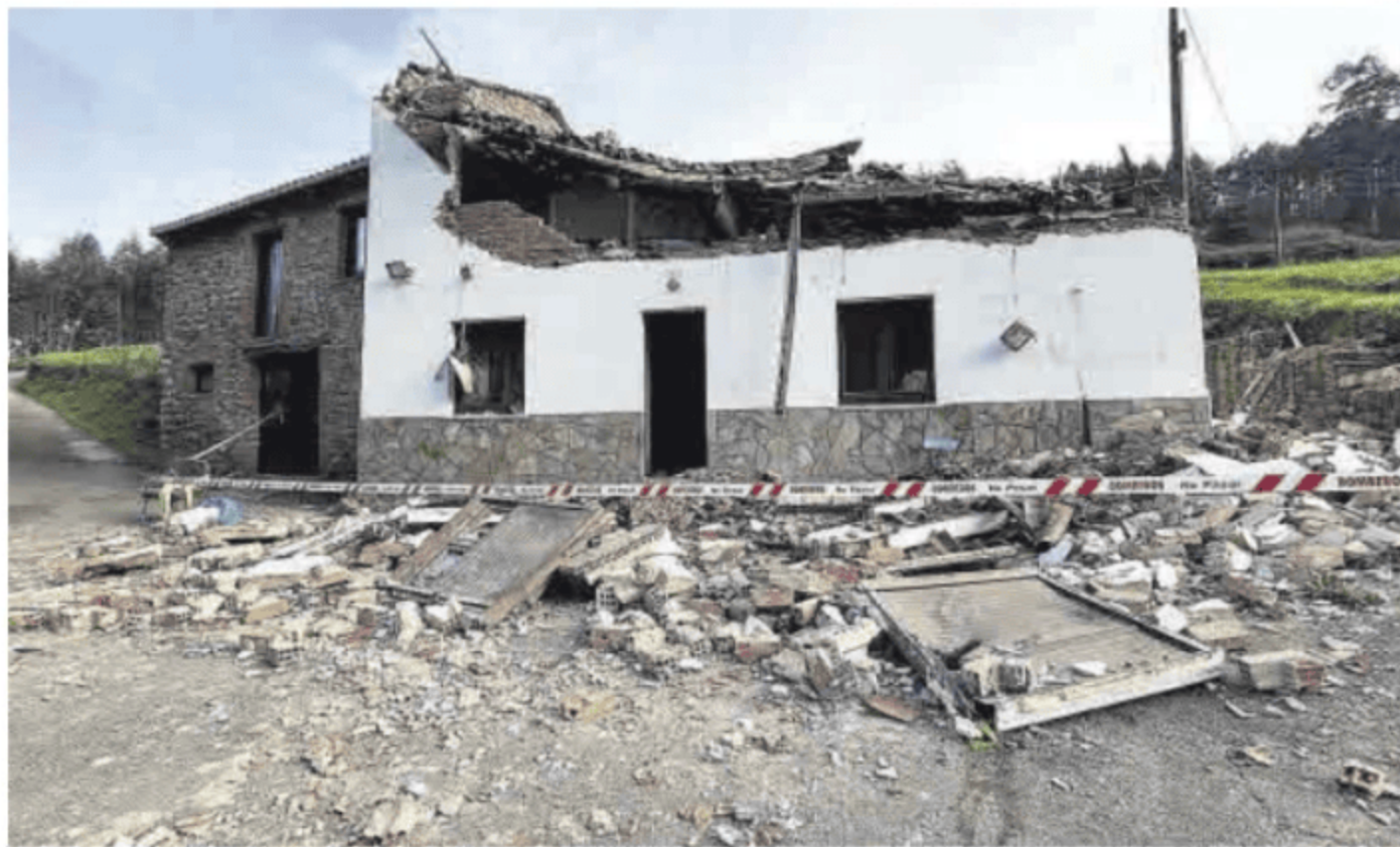
La vivienda de Budores afectada por el derrumbe del tejado.
